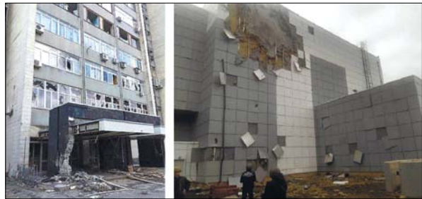
Рис. 5. Руйнування внаслідок обстрілу адміністративного корпусу Національного наукового центру «Харківський фізико-технічний інститут» і будівлі, де розміщена підкритична ядерна установка «Джерело нейтронів»
